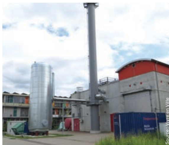
Figure 2.4.t LA CENTRALE DE COGÉNÉRATION, LE PILIER DE L'AUTONOMIE ÉNERGÉTIQUE DU QUARTIER
