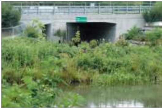
Figure 6-D : Étang de sédimentation.
