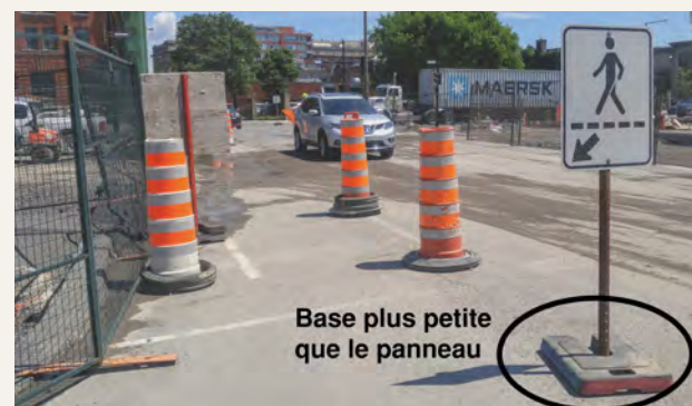
MAUVAIS EXEMPLE DE BASE DE PANNEAU
